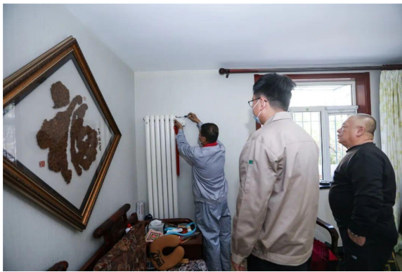
10月31日，城安热电公司供热服务管家入户为暖气排气
