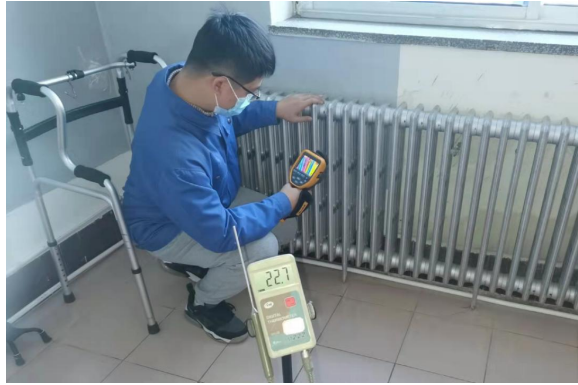
供热首日，热电公司军电第二供热服务中心供热服务管家到今年进行供热改造的马三立老人园测温查看供热效果
